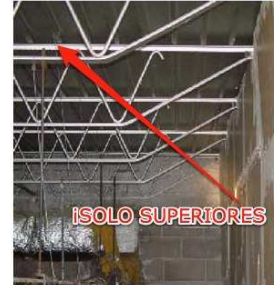
Figura 5 Viguetas de techos comerciales
